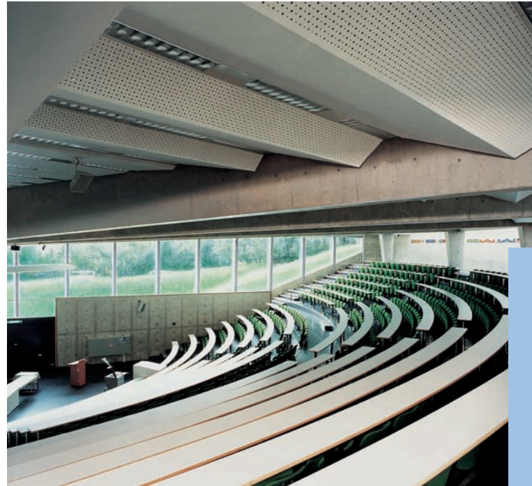
Ámbito de aplicación: enseñanza e investigación VARYCONTROL TVZ y TVA con componentes de regulación para su integración en el sistema de gestión del edificio así como RN/EN Universidad de Maastricht, Holanda.
